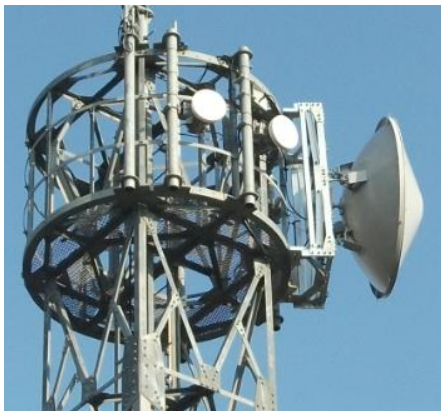
パラボラアンテナ取付架台
